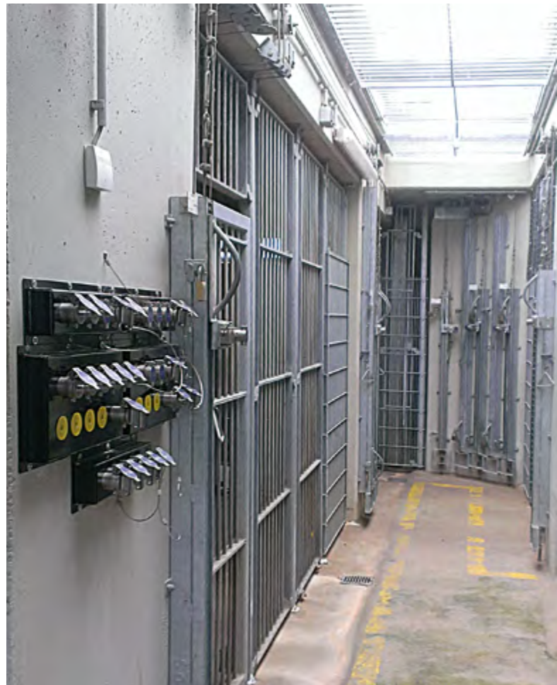
Abbildung 25: In der Schleuse befindet sich links die Schlüsselwechselstation des Schlüsseltransfersystems.
