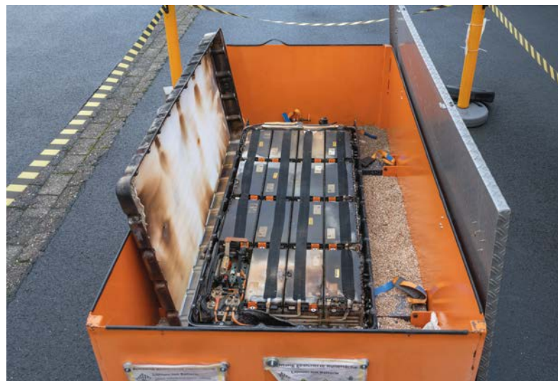
Abbildung 20: Beschädigte HV-Batterie nach Brand
