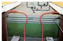
Abweisbügel gegen Absturzgefahr beim Rückwärtsgehen in der Unterfluranlage
